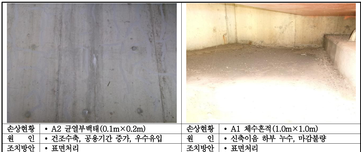
【사진 22.3.9】 교대 손상현황
